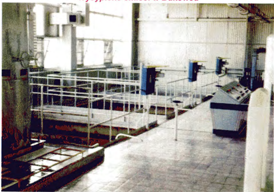
Stacja uzdatniania wody – wnętrze
