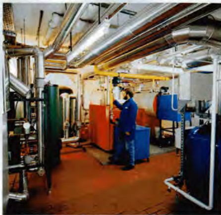
Nowoczesna kotłownia wykorzystująca gaz ziemny
