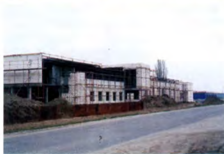
Trwa budowa nowej siedziby Straży Pożarnej przy drodze do Kalska. Zakończenie budowy w pełni nowoczesnej strażnicy przewidywane jest na grudzień br.
