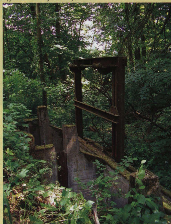
Zastawka regulująca przepływ Strugi Jeziornej ( fot. J. Krajniak )
