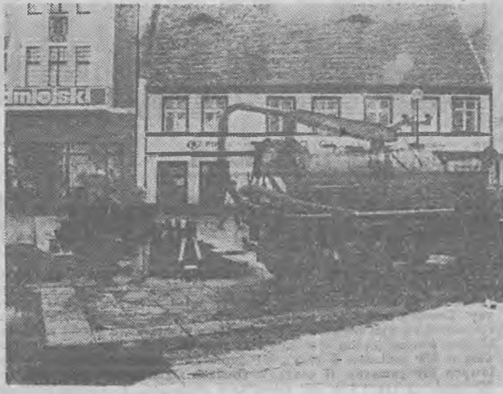
Na zielonogórskim deptaku stale coś się dzieje. Tym razem — awaria instalacji podziemnych.
