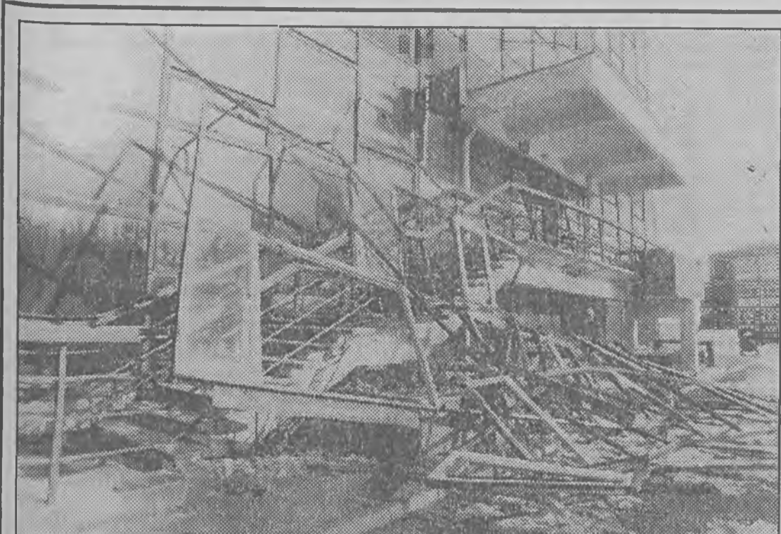
Ostatnio szalejąca wichura nie oszczędziła niczego i nikogo. W Lubinie uszkodziła między innymi stalowe obramowania Banku PKO S.A. Jak nas poinformowano trwają prace remontowe i za kilka dni bank ponownie będzie wyglądał jak dawniej. Fot. Marcin DREWS
