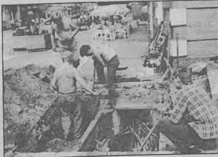
Przez kilka dni zielonogórzanie mieli niepowtarzalną okazję sprawdzenia co kryje się pod płytami deptaku. Pracownicy Zakładu Telekomunikacji powiększali studzienkę, którą biegną kable telefoniczne do centrów przy placu Pocztowym. Fot. Marek Woźniak
