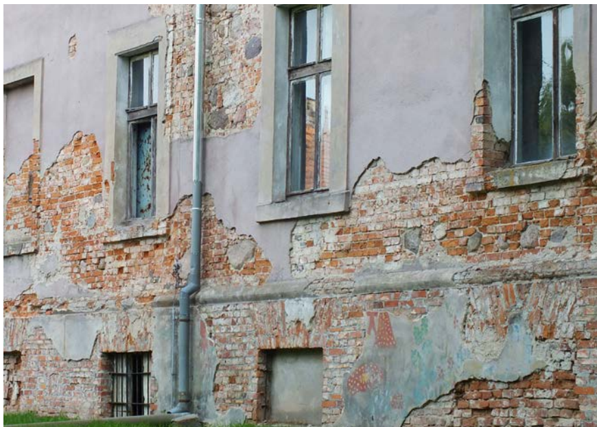
Ryc. 7. Ściana boczna zamku w Kargowej z widocznymi ubytkami tynku (widok obecny)
