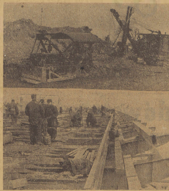
Na trasie W-Z w Warszawie dzięki zastosowaniu nowoczesnych maszyn (zdjęcie u góry) usuwanie gruzu i ziemi postępuje szybko i naprzód. Jednym z głównych ogniw trasy W-Z jest most Śląsko-Dąbrowski. Cała konstrukcja mostu jest już gotowa. W chwili obecnej (zdjęcie u dołu) zakłada się kable elektryczne.
