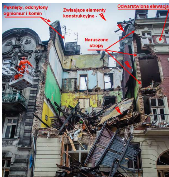
Fot. 1. Niestabilne elementy konstrukcyjne zawalonego w Katowicach budynku [Bąkowski 2015]
