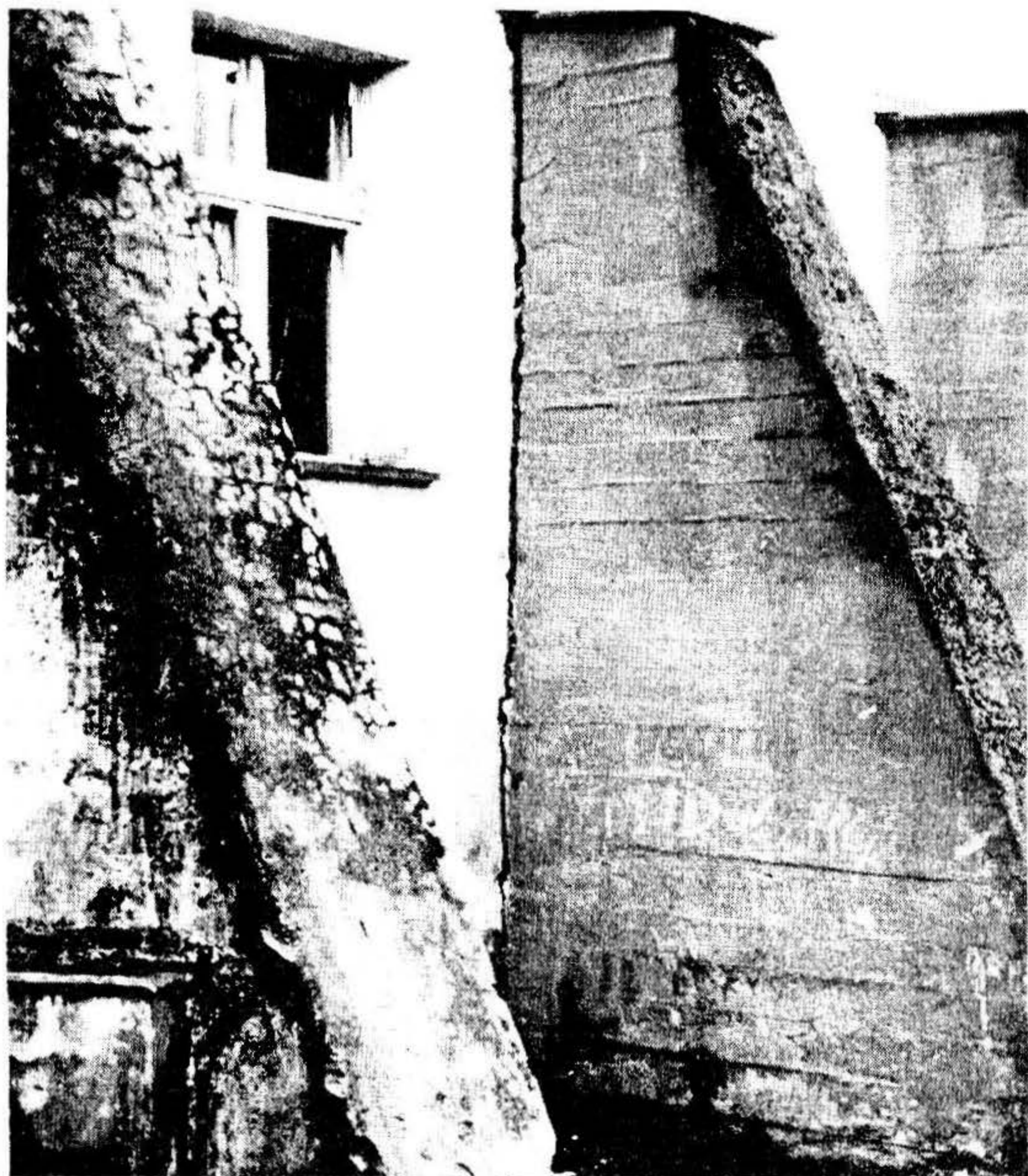
Fot. 2. Przykład odchylenia się przypór ścian budynku nad brzegiem Białej Łądeckiej w wyniku rozmycia gruntu pod fundamentami przy ul. Kościelnej
