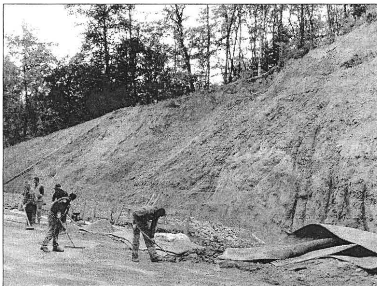
Fot. 4. Doraźne usunięcie skutków osuwiska, jakie w lipcu 2006 r. pojawiło się na obwodnicy Wilkanowa
