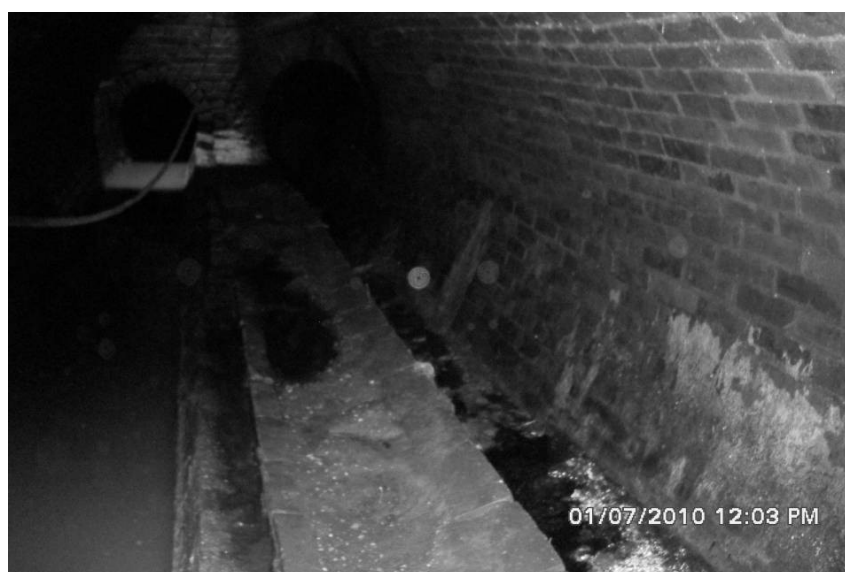
Fot. 2. Przelew burzowy PB-2 – ul. Nadbrzeźna (Nivus, Gdynia) Phot. 2. Overflow structure PB-2 – Nadbrzeźna street (Nivus, Gdynia)
