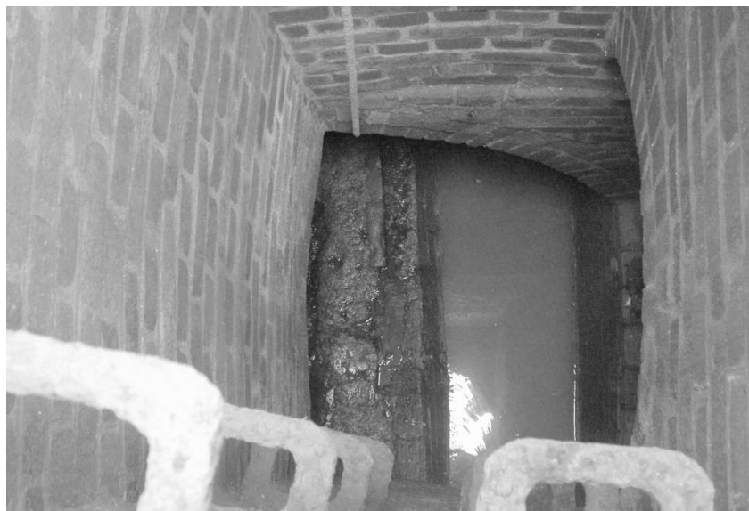
Fot. 1. Przelew burzowy PB-1 – ul. P. Skargi Phot. 1. Overflow structure PB-1 – P. Skargi street
