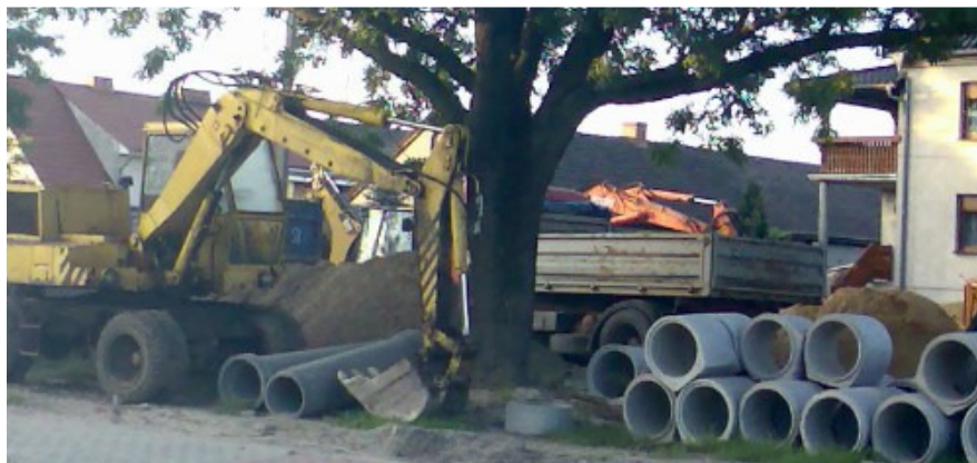
Fot. 6. Wadliwe zabezpieczone drzewo: postój, składowisko i brak osłony pnia. Gostawice (fot. EkoOpole 2009)
