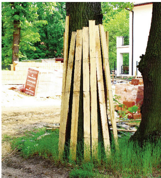
Fot. 4. Drzewo na placu budowy, nieodpowiednio zabezpieczone przed uszkodzeniami przy pomocy desek (fot. Greg 2010)
