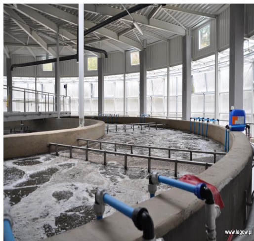
Fot. 2. Reaktor hybrydowy – widok Phot. 2. View of the biological reactor
