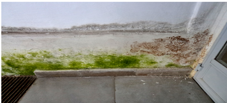
Fot. 1. Przykładowa elewacja z widoczną korozją biologiczną - budynek stołówki do remontu, UZ
