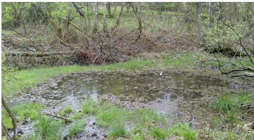
Fot. 1. Zastoisko wodne na koronie składowiska Phot. 1. Impounded water on the landfill crown
