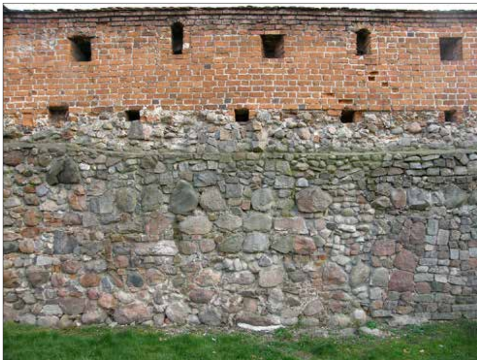
Ryc. 6. Zachowany fragment kamiennych murów obronnych z ceglana nadbudową, z przepnutymi otworami strzelniczymi w koronie płasko zakończonej ceglanej nadbudowy. W miejscu połączenia kamieni z cegłą widoczne są otwory po belkach drewnianego rusztowania w związku z podwyższeniem założenia lub istnienia drewnianego ganku od strony wewnętrznej muru, ul. Nowy Rynek w Sulechowie.
